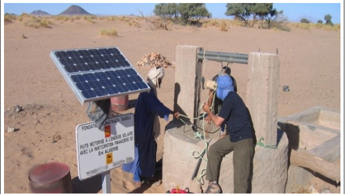
Pompage solaire dans le Sud Algérien.
