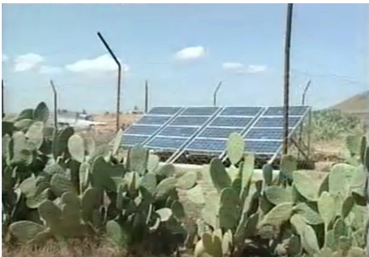
Puits équipé de panneaux solaires par le Haut Commissariat au Développement de la Steppe.
